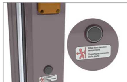
Mise hors tension temporaire pour ouverture manuelle
